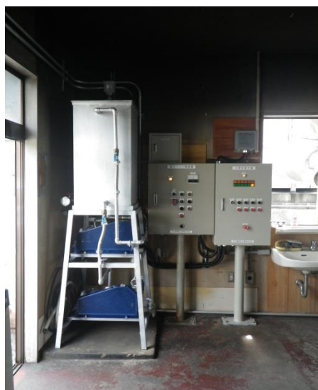
写真一 6 操作盤及び サービスタンク
